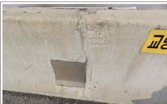
방호벽 하행선 S2 수직균열(CW=0.3mm)
