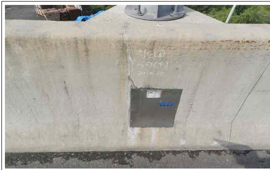
방호벽 하행선 S9 수직균열(CW=0.2mm)
