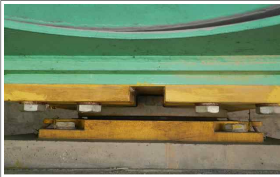
교량받침 상행선 A1 SH1 상부플레이트 와셔 녹발생
