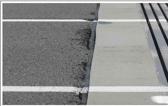
교면포장 하행선 S11(P10) 아스콘 패임
