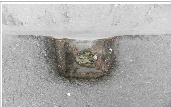
배수시설 하행선 S3 배수구 그레이팅 망실
