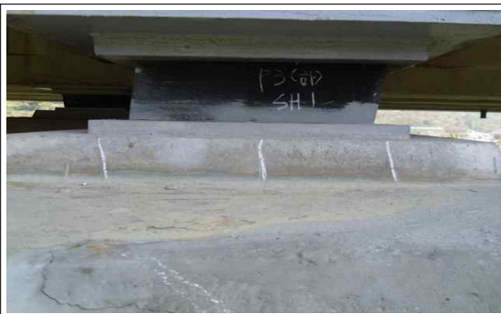
교량받침 하행선 P3 SH1 무수축물탈 균열 (CW=0.1mm)
