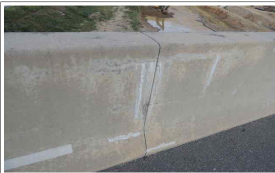
방호벽 상행선 S6 균열부 백태
