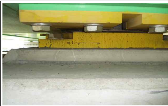
교량받침 하행선 P14 SH2 무수축물탈 균열 (CW=0.1mm)
