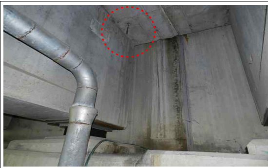
배수시설 상행선 S1(A1) 유도배수관 길이부족
