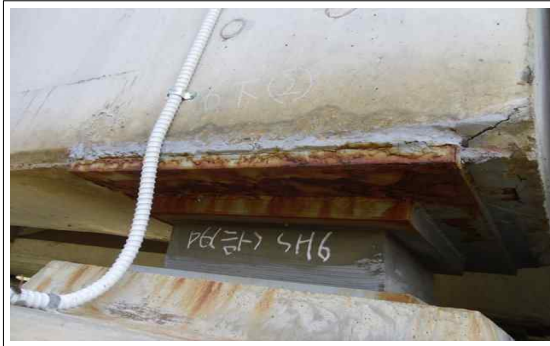
교량받침 하행선 P6 SH6 상부플레이트 녹발생
