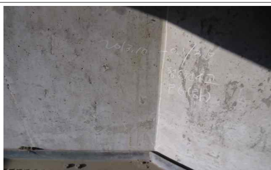
교각 하행선 P6 코핑부 수직균열 (CW=0.1mm)
