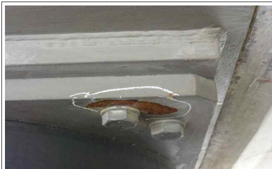
교량받침 하행선 P6 SH1 상부 플레이트 녹발생
