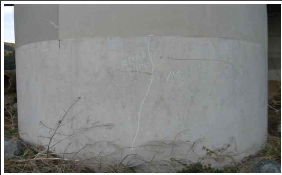
교각 하행선 P7 기둥부 수직균열 (CW=0.2mm)
