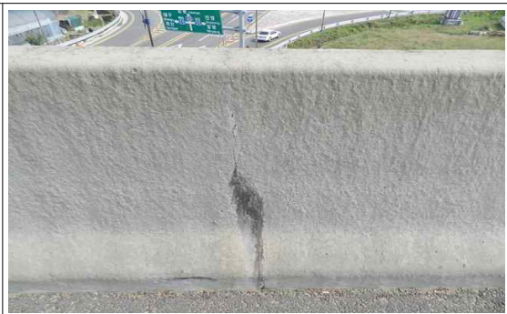
방호벽 상행선 S14 수직균열(CW=0.3mm)
