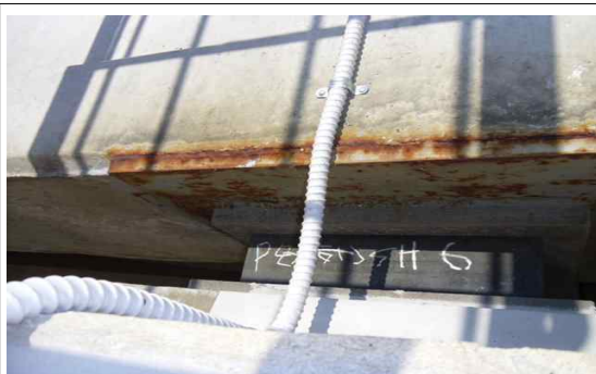
교량받침 하행선 P8 SH6 상부플레이트 녹발생
