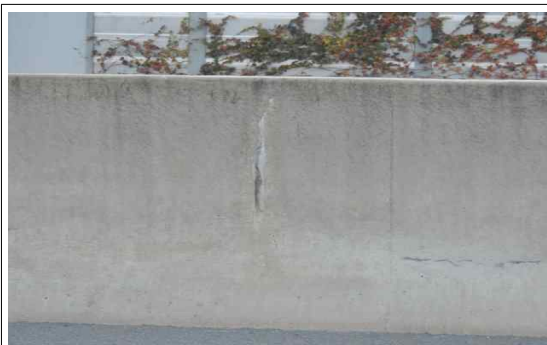
중분대 상행선 S1 균열부 백태
