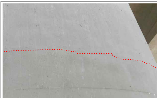
교각 하행선 P5 기둥부 수평균열 (CW=0.1mm)
