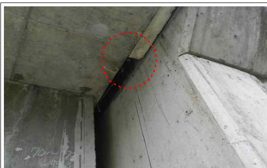
배수시설 하행선 S3(P3) 유도배수관 길이부족
