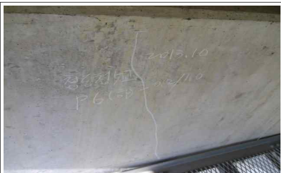
교각 하행선 P6 코핑부 수직균열 (CW=0.2mm)
