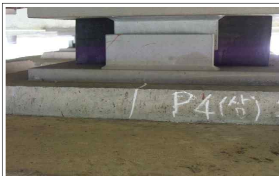
교량받침 상행선 P4 SH8 무수축물탈 균열 (CW=0.1mm)
