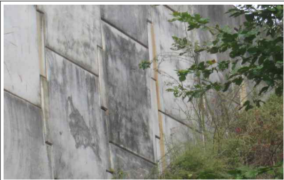
보강토 조립식 옹벽 S8 누수흔적 및 백태
