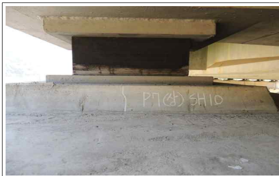
교량받침 상행선 P7 SH10 무수축물탈 균열 (CW=0.1mm)
