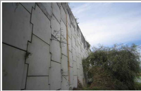
보강토 조립식 옹벽 S3 누수흔적
