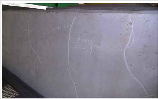
교각 하행선 P1 코핑부 수직균열(CW=0.1mm)
