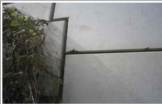
보강토 조립식 옹벽 S7 판넬 파손
