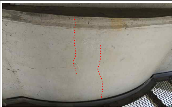
교각 상행선 P7 코핑부 수직균열(CW=0.1mm)
