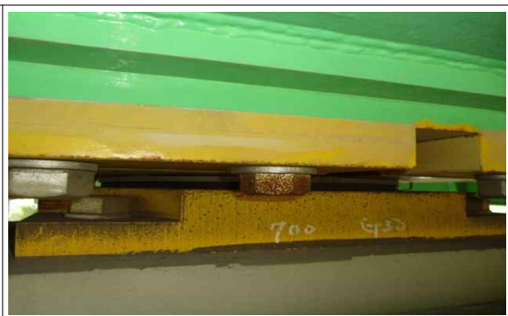
교량받침 하행선 P9 SH1 플레이트 볼트 녹발생
