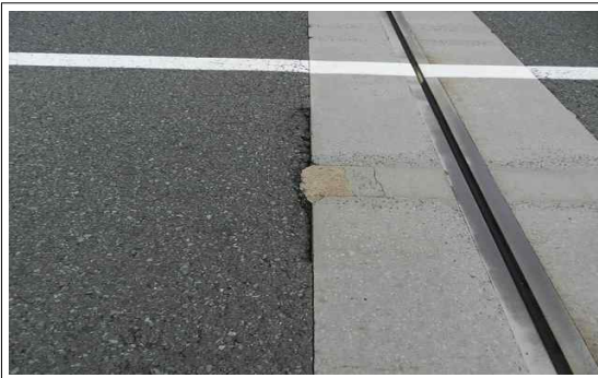
교면포장 하행선 S12(A2) 아스콘 패임
