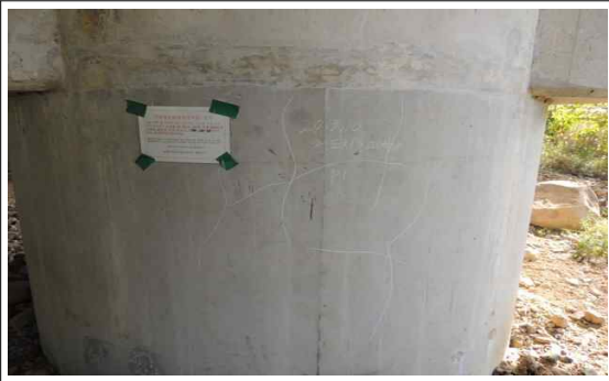
교각 하행선 P1 기둥부 망상균열
