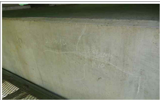
교각 상행선 P10 기둥부 수평균열(CW=0.1mm)
