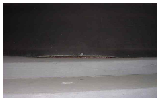
교량받침 하행선 P8 SH1 하부 고무재 들뜸
