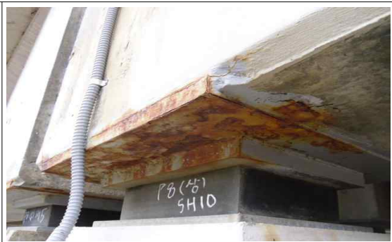
교량받침 상행선 P8 SH10 상부플레이트 녹발생
