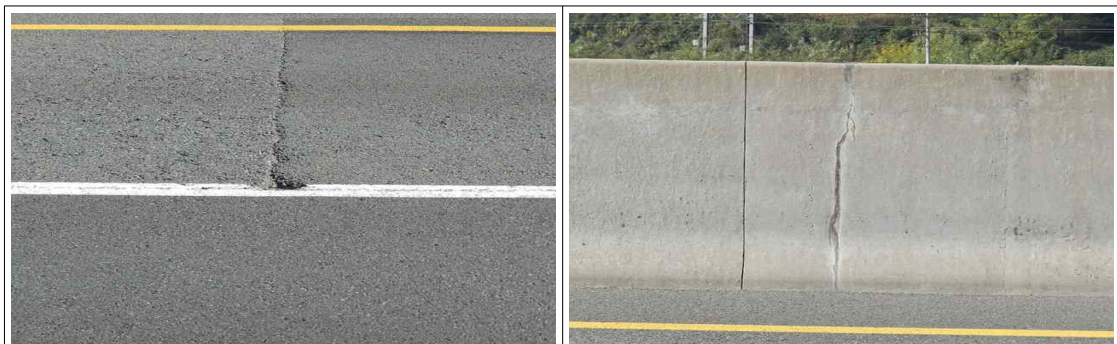
교면포장 하행선 S9 아스콘 패임
