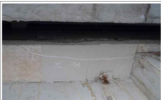
바닥판하면 하행선 S6(P6) 보수부 재균열 (CW=0.2mm)
