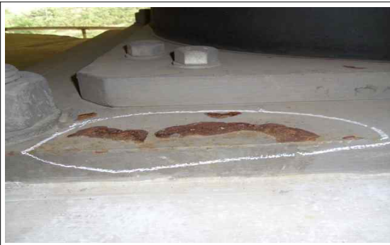
교량받침 상행선 P6 SH1 하부플레이트 녹발생
