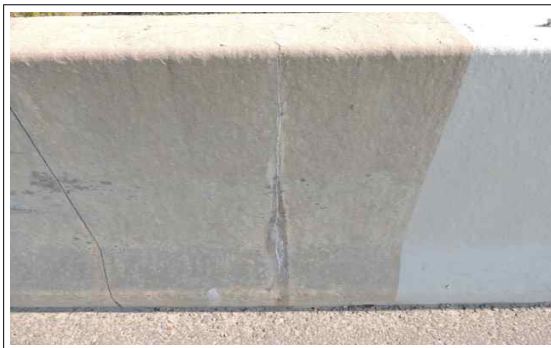
방호벽 상행선 S5 수직균열(CW=0.2mm)
