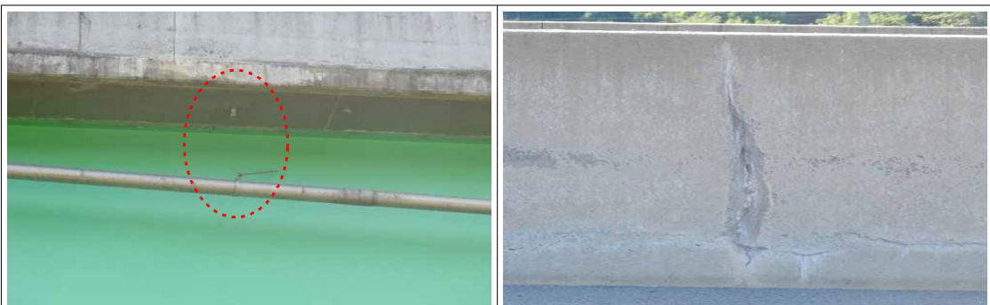
배수시설 상행선 S1 배수관 지지대탈락
