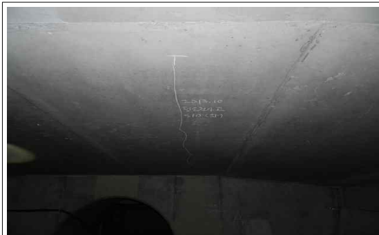
주형내부 하행선 S10 상면 종방향 균열 (CW=0.1mm)
