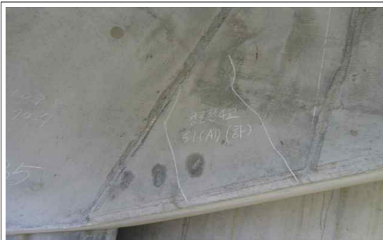
주형외부 상행선 S1 균열(CW=0.2mm)
