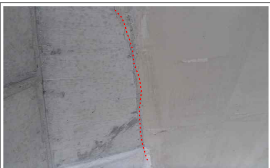
주형외부 상행선 S1 균열(CW=0.3mm)
