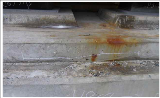
교량받침 상행선 P3 SH5 받침콘크리트 균열 (CW=0.2mm)
