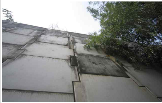
보강토 조립식 옹벽 S2 누수흔적
