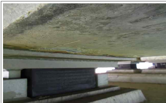
주형 하행선 S4 G3 플레이트 매립부 파손
