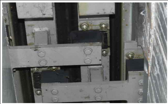
신축이음 하행선 Exp.J1(A1) 고무베어링 탈락
