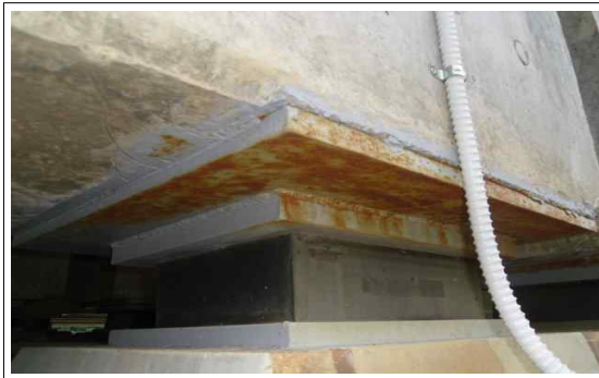
교량받침 하행선 P9 SH6 상부플레이트 녹발생
