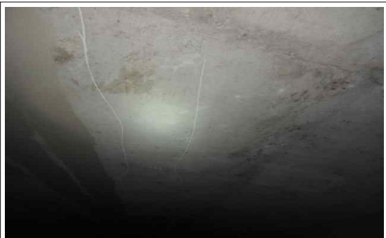
주형내부 상행선 S1 상면 종방향 균열 (CW=0.1mm)
