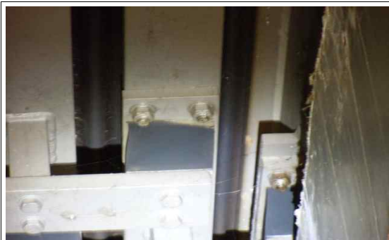
신축이음 상행선 Exp.J1(A1) 고무베어링 탈락
