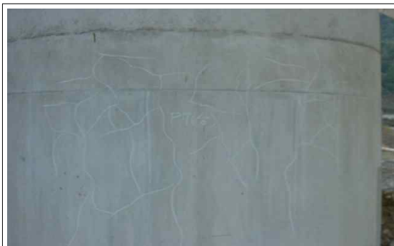
교각 상행선 P7 기둥부 망상균열
