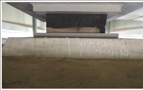
교량받침 하행선 P7 SH10 무수축몰탈 균열 (CW=0.1mm)
