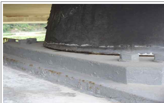
교량받침 상행선 P10 SH4 하부 고무재 드뭇
