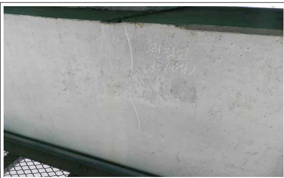
교각 상행선 P1 수직균열(CW=0.1mm)
