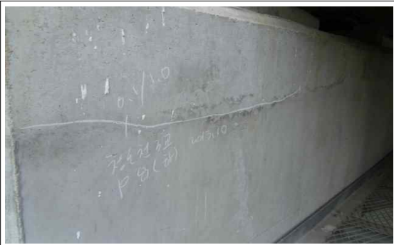
교각 하행선 P8 코핑부 수평균열(CW=0.1mm)
