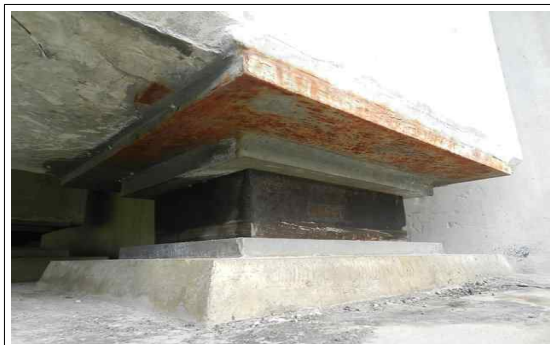
교량받침 하행선 A1 SH1 상부플레이트 녹발생
