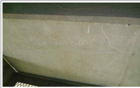
교각 상행선 P5 코핑부 수직, 수평균열 (CW=0.1mm)
