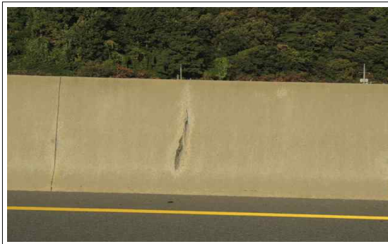
중분대 하행선 S6 균열부 백태
