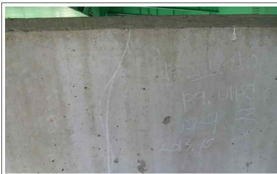
교각 상행선 P9 기둥부 수직균열(CW=0.1mm)
