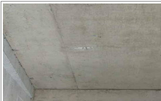
바닥판하면 하행선 S10 균열부 백태
