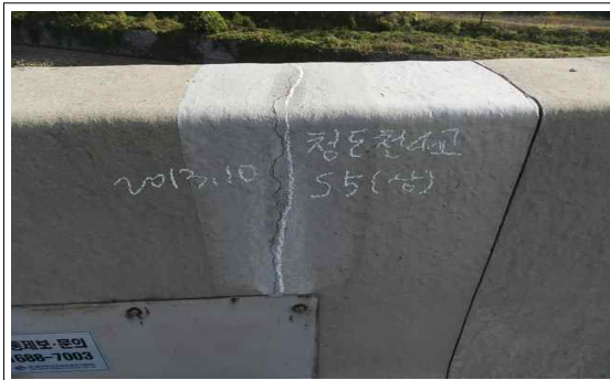
방호벽 상행선 S5 수직균열(CW=0.1mm)
