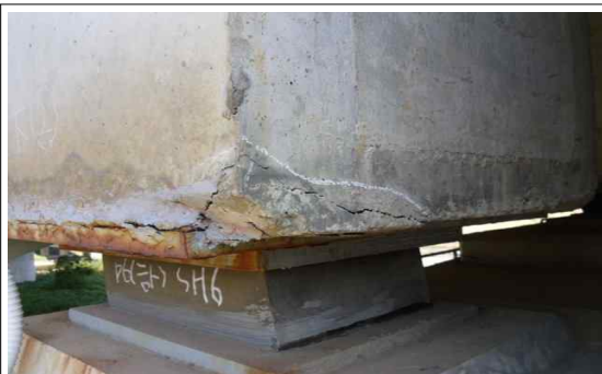
주형 하행선 S7 G1 플레이트 매립부 파손
