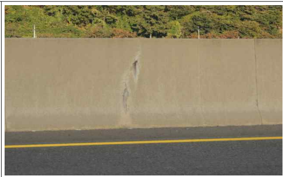
중분대 하행선 S10 균열부 백태
