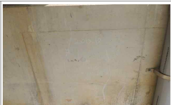
교대 하행선 A1 구체 망상균열
