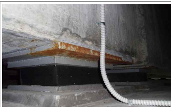
교량받침 상행선 P9 SH6 상부플레이트 녹발생
