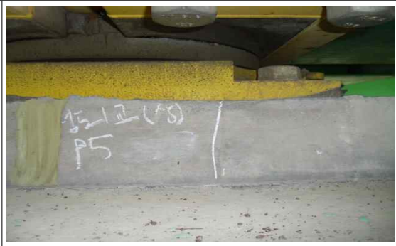
교량받침 상행선 P5 SH3 무수축물탈 균열 (CW=0.1mm)
