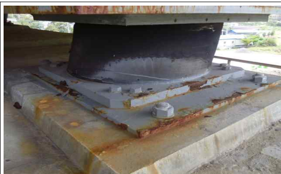
교량받침 하행선 P10 SH1 상, 하부 플레이트 녹발생
