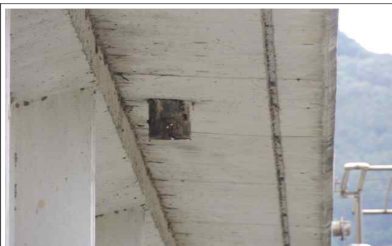
배수시설 하행선 S10 배수관 탈락
