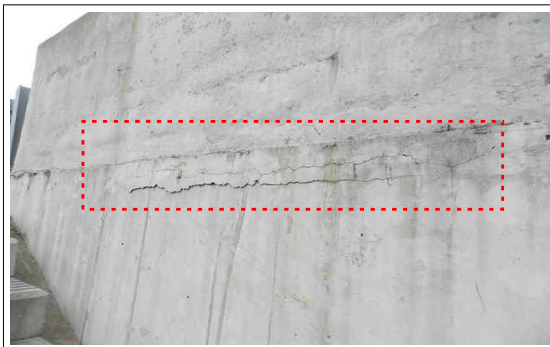
교대 상행선 A1 날개벽 콘크리트 박리
