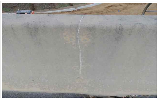
방호벽 상행선 S9 수직균열(CW=0.1mm)
