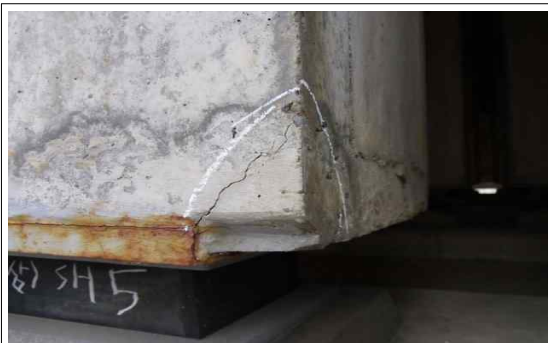
주형 상행선 S8 G5 플레이트 매립부 파손
