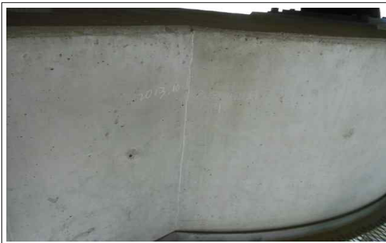
교각 상행선 P1 코핑부 수직균열 (CW=0.1mm)
