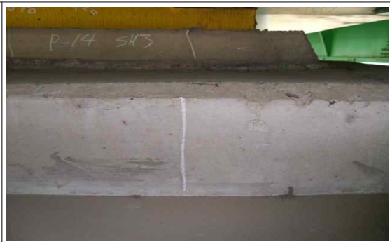
교량받침 하행선 P14 SH3 받침콘크리트 균열 (CW=0.1mm)
