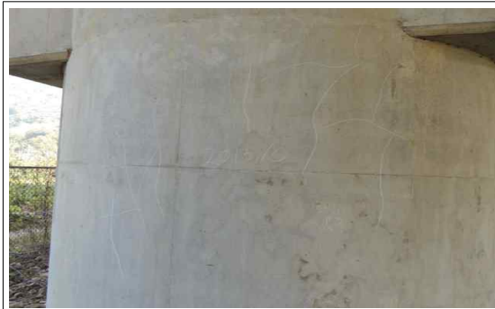
교각 상행선 P3 기둥부 망상균열
