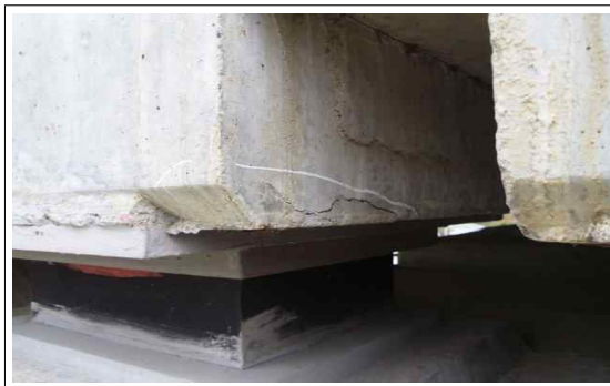
주형 하행선 S12 G1 플레이트 매립부 파손
