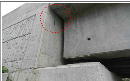
배수시설 하행선 S12(A2) 유도배수관 길이부족
