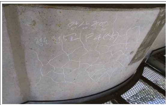
교각 상행선 P4 코핑부 망상균열
