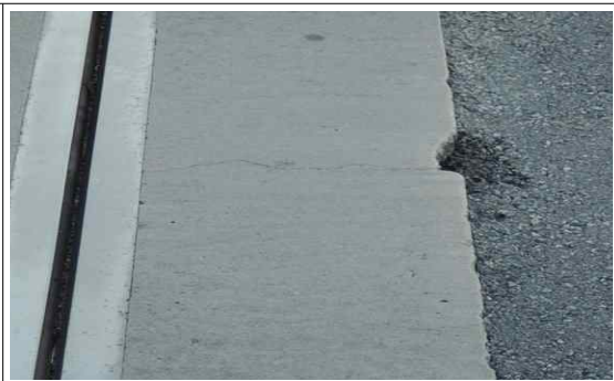
신축이음 상행선 Exp.J4(P8) 후타재 균열 (CW=0.3mm)
