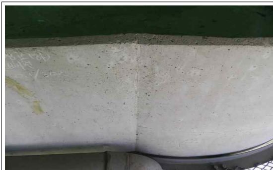
교각 하행선 P2 수직균열(CW=0.2mm)
