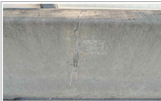
방호벽 상행선 S11 수직균열(CW=0.2mm)
