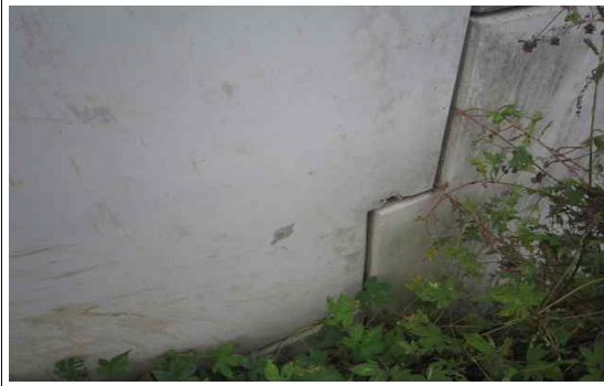
보강토 조립식 옹벽 S1 판넬 파손
