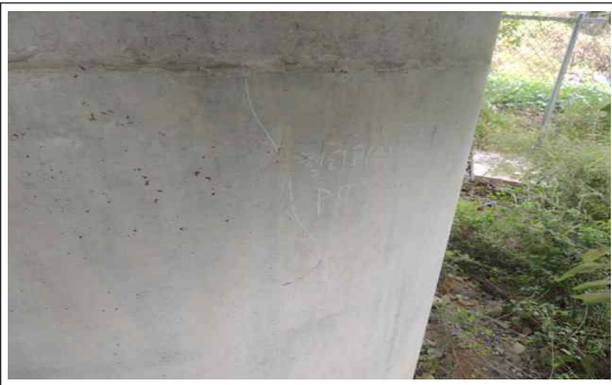
교각 상행선 P7 기둥부 수직균열(CW=0.1mm)
