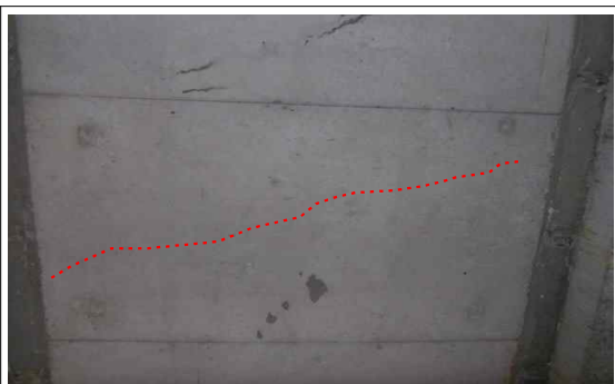
바닥판하면 상행선 S9 횡방향 균열 (CW=0.2mm)
