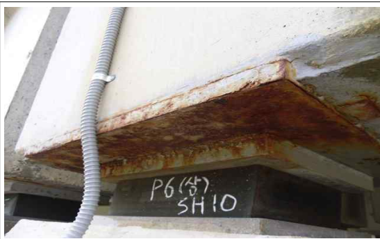
교량받침 상행선 P6 SH10 상부플레이트 녹발생
