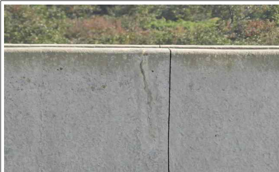
방호벽 하행선 S7 수직균열(CW=0.1mm)
