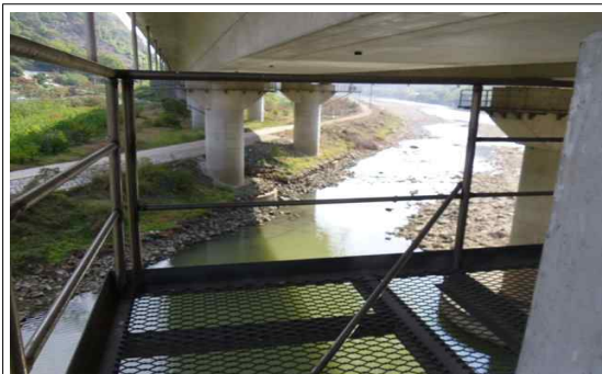
부대시설 상행선 P4 점검로 난간파손
