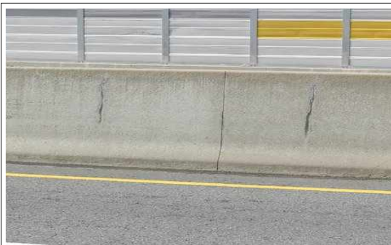
중분대 상행선 S5 균열부 백태
