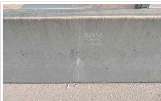
방호벽 상행선 S9 수직균열(CW=0.2mm)
