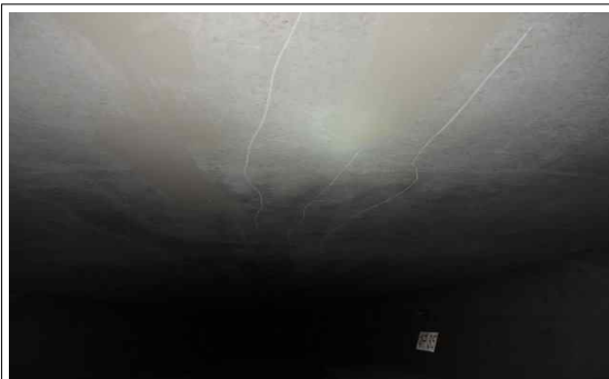
주형내부 상행선 S5 상면 종방향 균열 (CW=0.1mm)
