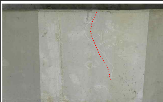
교대 하행선 A2 구체 수직균열(CW=0.1mm)
