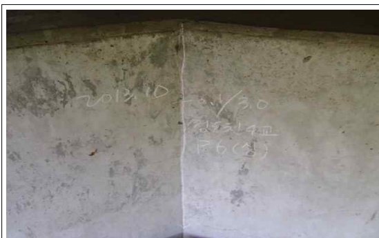
교각 상행선 P6 코핑부 수직균열 (CW=0.1mm)
