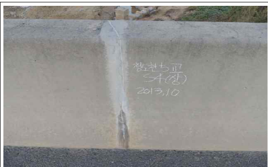
방호벽 상행선 S4 수직균열(CW=0.1mm)
