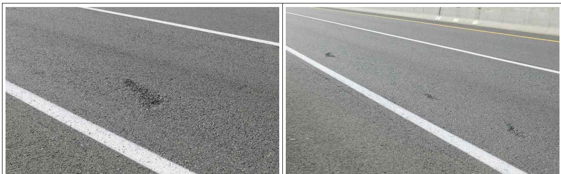
교면포장 상행선 S7 아스콘 패임
