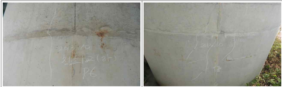
교각 하행선 P6 기둥부 수직균열(CW=0.1mm)
