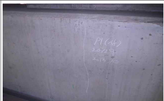
교각 상행선 P1 코핑부 수직균열(CW=0.1mm)
