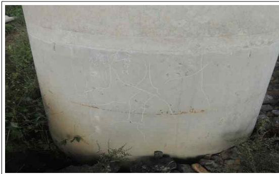
교각 상행선 P11 기둥부 망상균열
