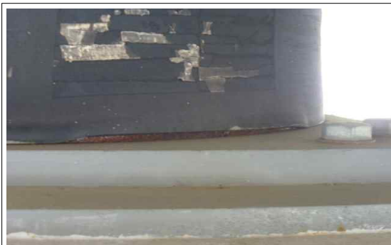
교량받침 상행선 P1 SH1 하부 고무재 들뜸
