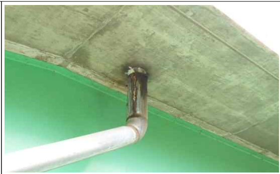
배수시설 상행선 S1 배수관 녹발생
