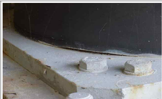
교량받침 상행선 A1 SH2 하부 고무재 들뜸
