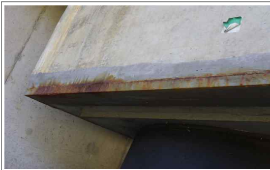
교량받침 상행선 A1 SH2 상부플레이트 녹발생
