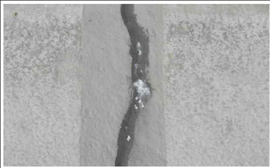
방호벽 하행선 S3 보수부 백태
