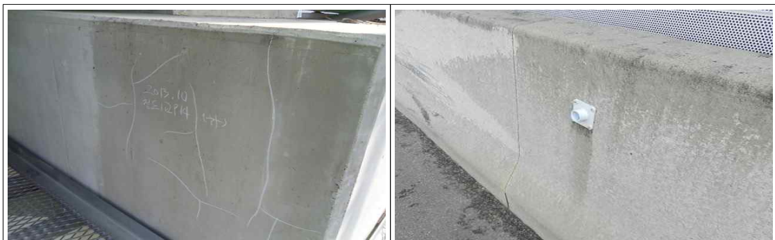
교각 하행선 P14 코핑부 망상균열
