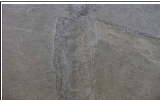
주형외부 상행선 S1 균열(CW=0.3mm)
