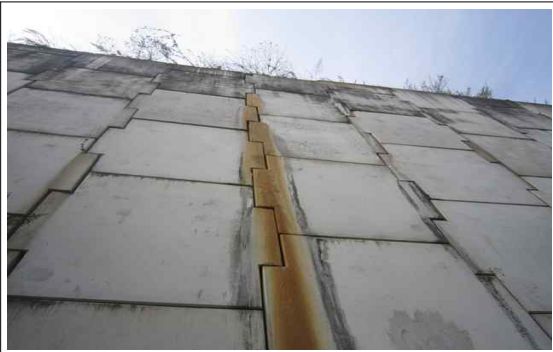
보강토 조립식 옹벽 S3 상부 누수흔적
