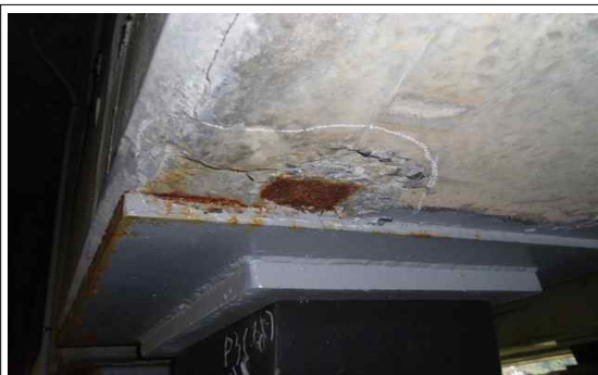
주형 상행선 S3 G1 플레이트 매립부 파손
