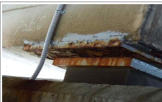
교량받침 상행선 P6 SH6 상부플레이트 녹발생
