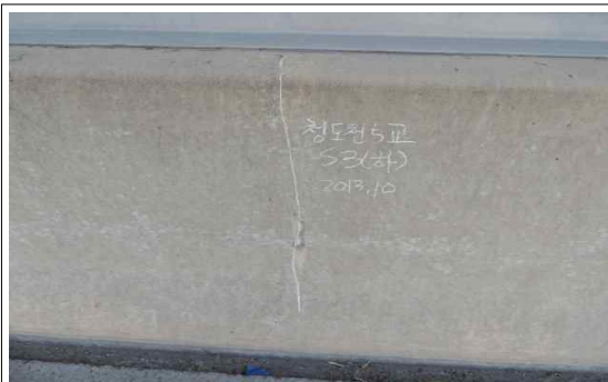
방호벽 하행선 S3수직균열(CW=0.1mm)
