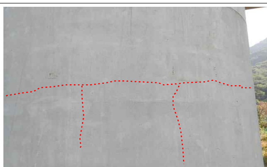
교각 하행선 P2 기둥부 수직, 수평균열 (CW=0.1mm)
