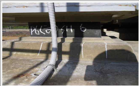
교량받침 하행선 S6 SH6 무수축물탈 균열 (CW=0.1mm)
