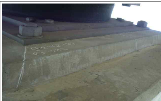
교량받침 하행선 P3 SH2 무수축물탈 균열 (CW=0.1mm)
