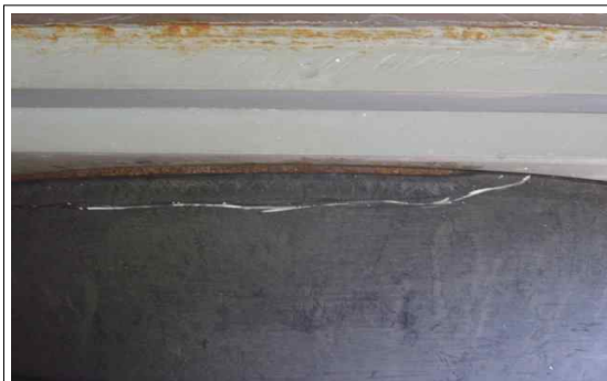
교량받침 상행선 P19 SH2 상부 고무재 들뜸
