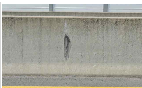
중분대 상행선 S1 균열부 백태
