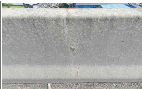
방호벽 상행선 S12 수직균열(CW=0.2mm)
