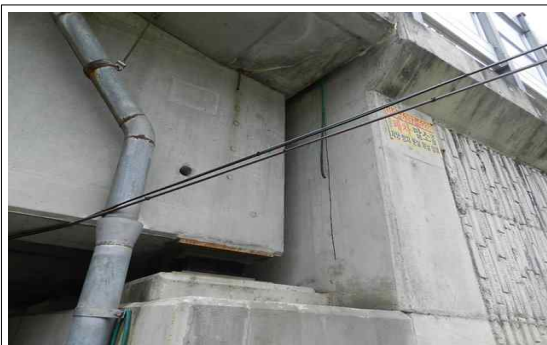
배수시설 하행선 S1(A1) 유도배수관 길이부족
