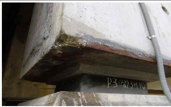
교량받침 상행선 P3 SH10 상부플레이트 녹발생
