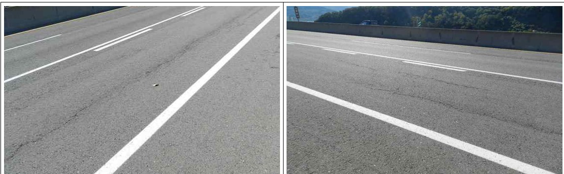
교면포장 상행선 S1 아스콘 균열
