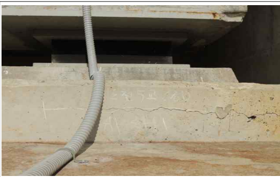
교량받침 하행선 A1 SH1 받침콘크리트 균열 (CW=0.1mm)
