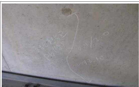
교각 상행선 P6 코핑부 수직균열 (CW=0.1mm)
