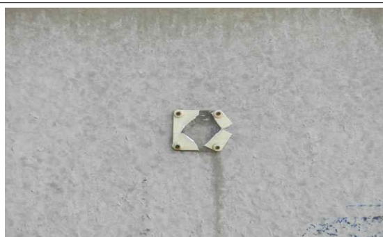
부대시설 하행선 S2 텔리네이터 파손
