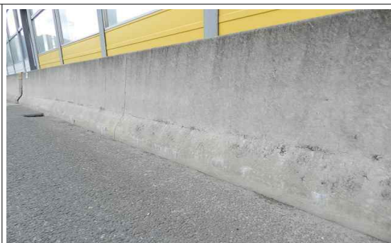
방호벽 하행선 S7 수평균열(CW=0.1mm)
