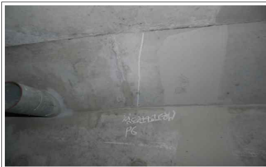
주형내부 하행선 S6 격벽(대구) 균열 (CW=0.1mm)
