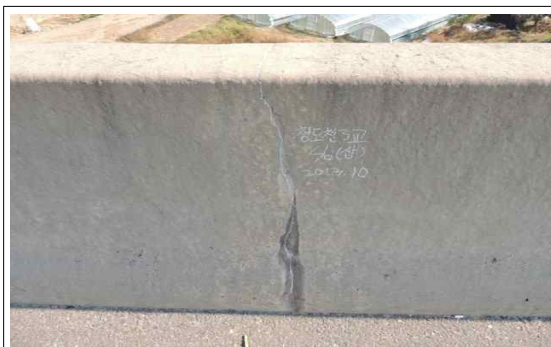
방호벽 상행선 S6 균열부 백태
