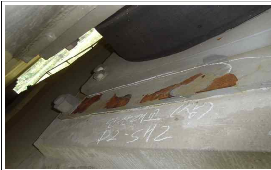
교량받침 상행선 P2 SH2 하부플레이트 녹발생
