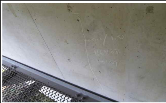
교각 하행선 P3 코핑부 수직균열(CW=0.1mm)
