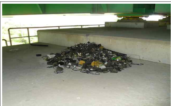
교각 하행선 P5 코핑부 폐자재 적치
