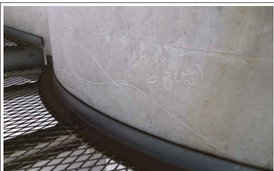
교각 상행선 P8 코핑부 수평균열 (CW=0.2mm)
