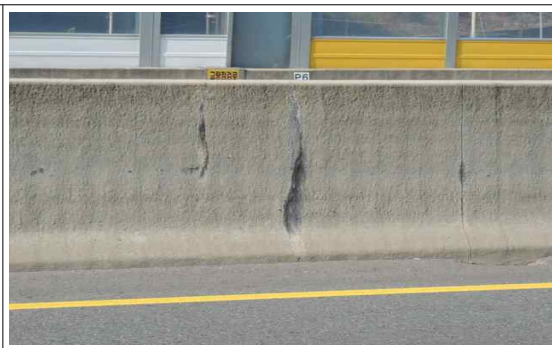
중분대 상행선 S6 균열부 백태
