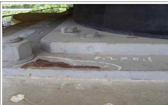
교량받침 상행선 P16 SH2 하부플레이트 녹발생
