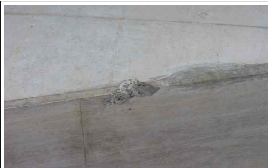
교각 하행선 P9 코핑부 콘크리트 파손
