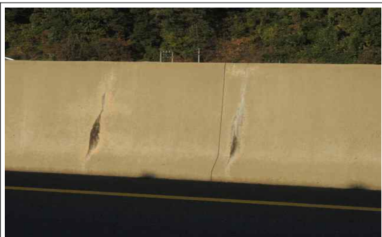
중분대 하행선 S4 균열부 백태
