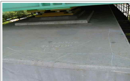
교각 하행선 P3 코핑부 망상균열
