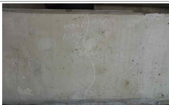
교대 상행선 A2 구체 수직균열(CW=0.2mm)
