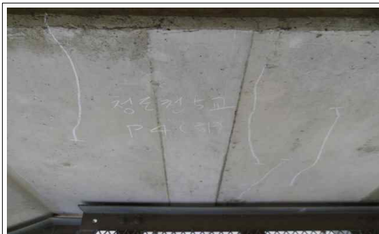
교각 하행선 P4 코핑부 수직균열 (CW=0.1mm)
