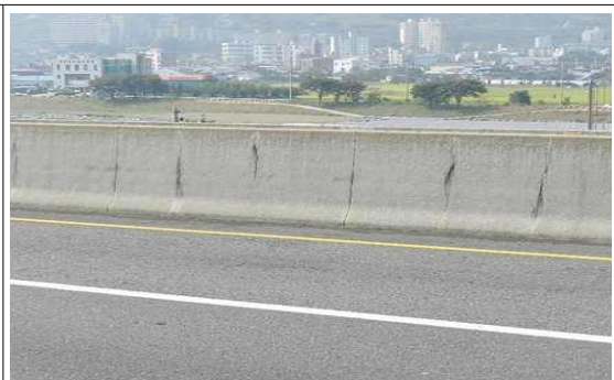
중분대 상행선 S10 균열부 백태
