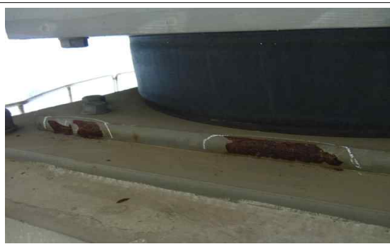
교량받침 하행선 P6 SH2 하부플레이트 녹발생
