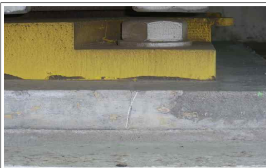
교량받침 하행선 P7 SH1 무수축물탈 균열 (CW=0.1mm)
