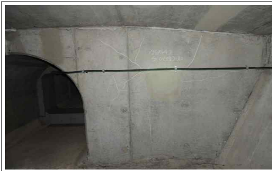
주형내부 상행선 S10 격벽(대구) 망상균열
