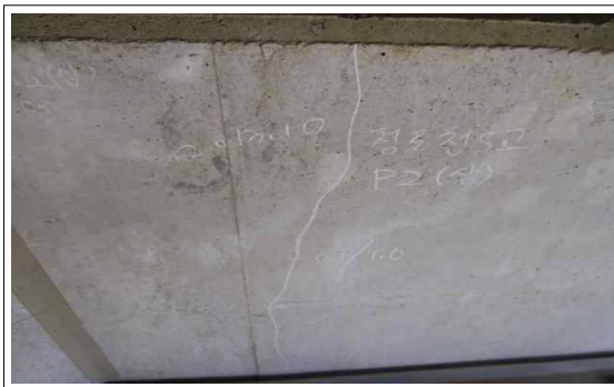
교각 상행선 P2 코핑부 수직균열(CW=0.1mm)
