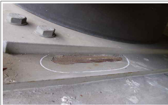
교량받침 상행선 P9 SH2 하부플레이트 녹발생
