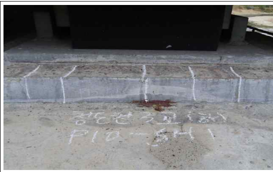
교량받침 하행선 P10 SH1 무수축몰탈 균열 (CW=0.1mm)
